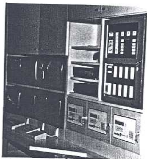
Sala de control del sistema de seguridad.
