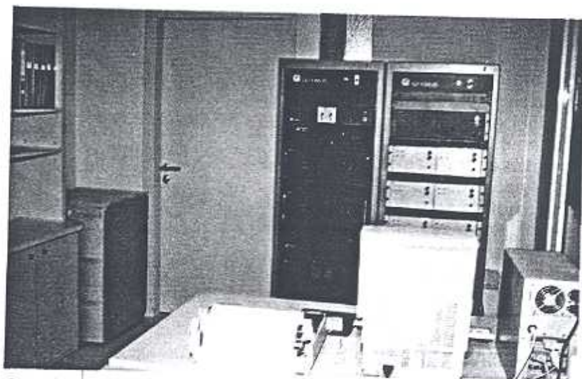
Central de megafonía y control del sistema de gestión del edificio.
